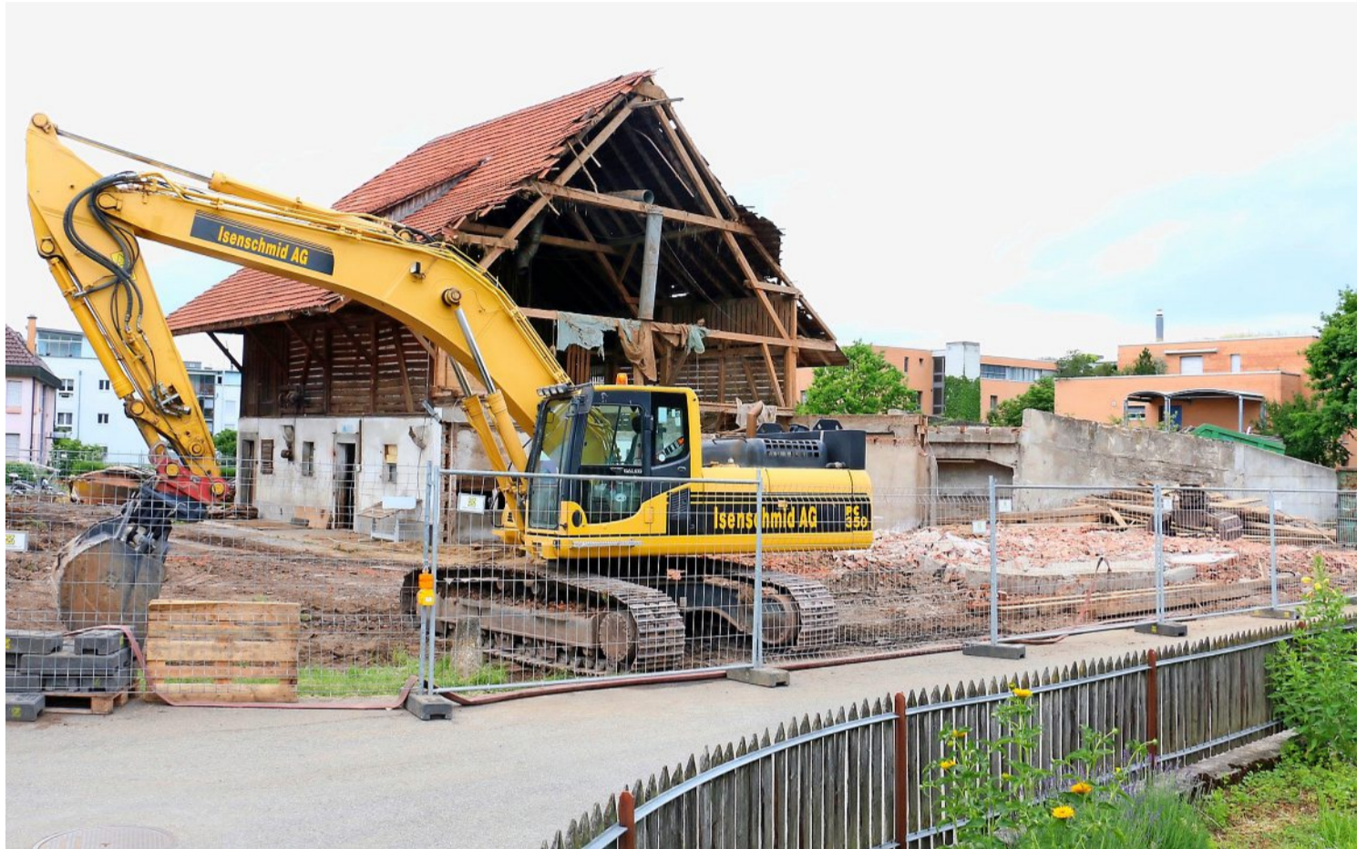
Mit dem Abbruch des alten Bauernhauses, der noch bis Ende Monat läuft, wird der Weg für den Bau des Mehrgenerationenhauses am Weberweg in Steffisburg frei gemacht. Foto: Andreas Tschopp
